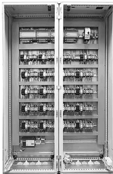
Рис. 1. Шкаф управления обессоливающими цепочками
