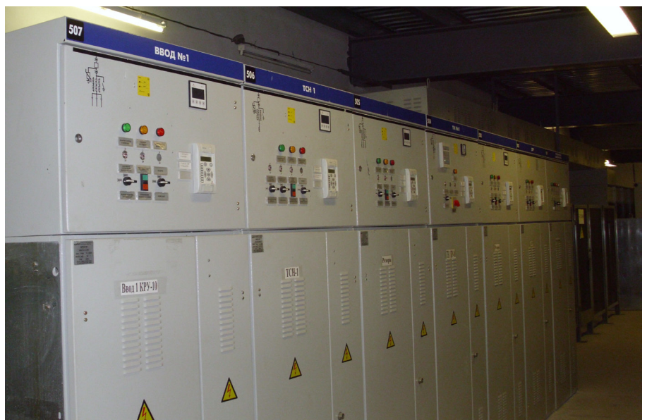
Рис. 3. Устройства токовой защиты одной подстанции
