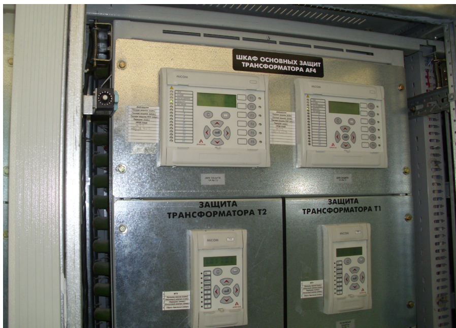
Рис. 1. Шкаф с микропроцессорными реле защиты MiCOM
