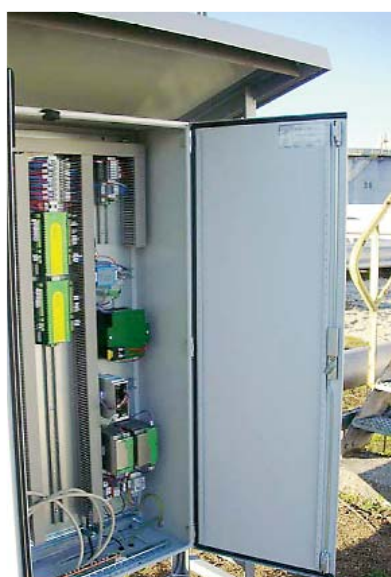
Рис. 2. УСО для резервуаров с хлором
