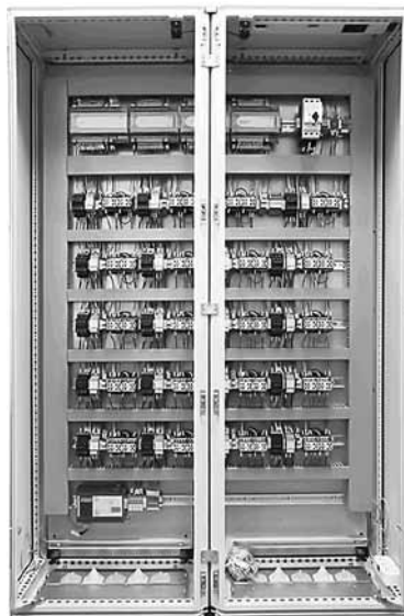
Рис. 1. Шкаф управления обессоливающими цепочками
